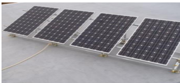
図6 追加の太陽光パネル(定格出力250W/枚)
