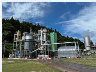
▲木質バイオマス発電施設
