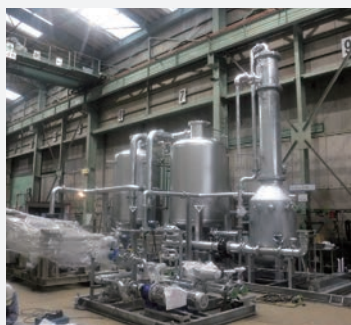
▲油槽所向けガソリンペーパー回収装置
