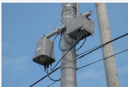
▲配電自動化システム
