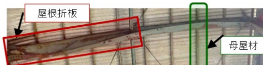
図 1 被害写真 (H 形鋼梁の横座屈)
