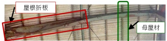
図1 被害写真 (H 形鋼梁の横座屈)
