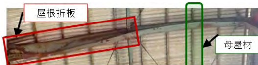
図1 被害写真 (H 形鋼梁の横座屈)
